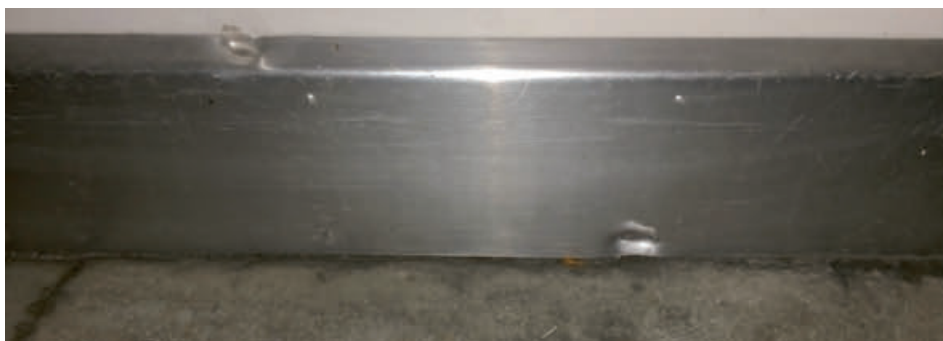
Immer noch nicht entfernt: Die Einschusslöcher an der Eingangstüre.
